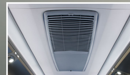
Grade de ar-condicionado integrada ao teto
